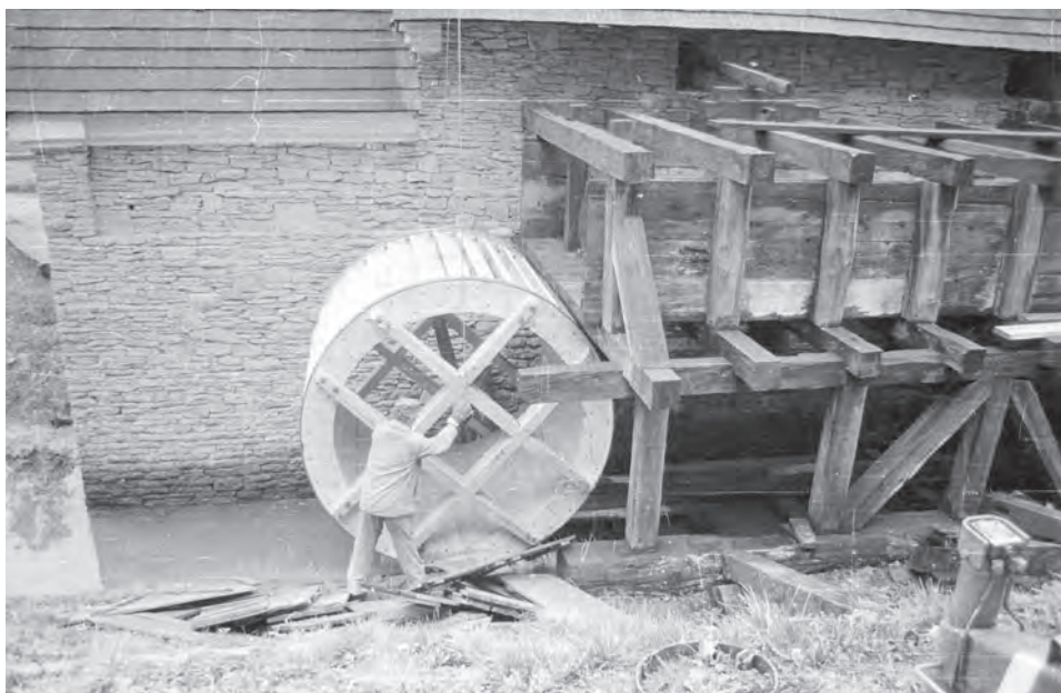
Obr. 3. Montáž vodního kola u hamru z Ostravice v Mlýnské dolině. Fotoarchiv Valašského muzea v přírodě. Foto J. Jurka, 1998
